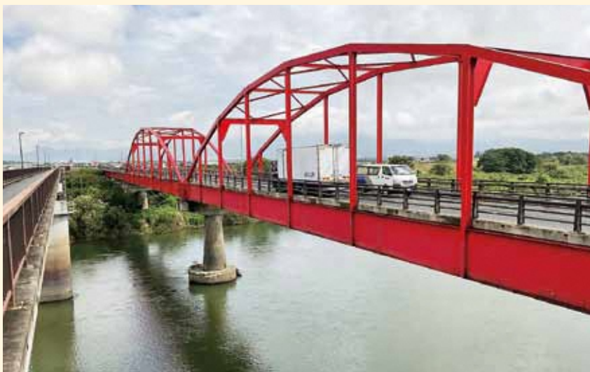
早期な老朽化対策が望まれる河北橋
