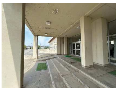
庇・屋根の劣化による雨漏り
