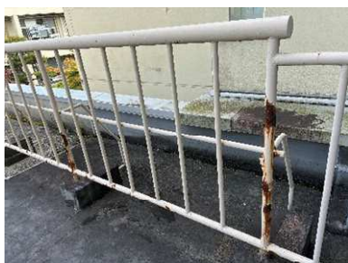
手すり等の腐食
