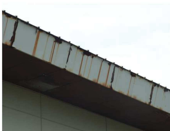
金属屋根の劣化状況
