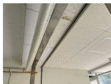
エキスパンションジョイント部の雨漏り
