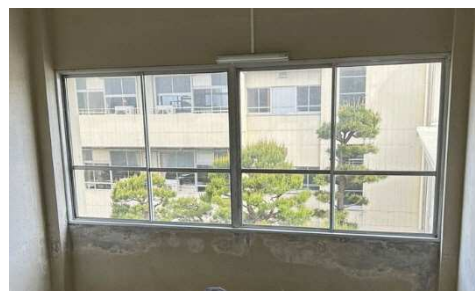
階段窓部の結露による壁面の劣化
