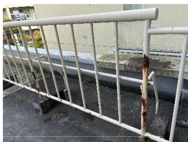
手すり等の腐食
