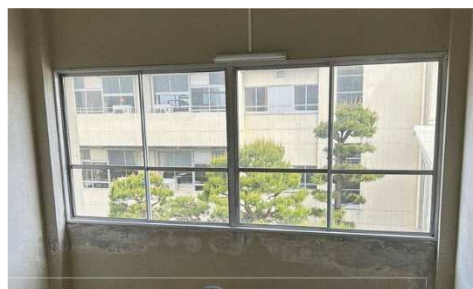
階段窓部の結露による壁面の劣化
