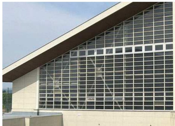
特殊な窓形状により修理できず、空いたままの体育館窓
