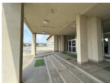
庇・屋根の劣化による雨漏り
