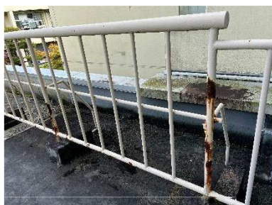
手すり等の腐食
