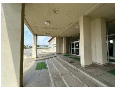
庇・屋根の劣化による雨漏り
