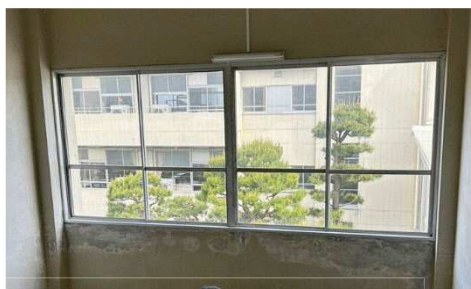
階段窓部の結露による壁面の劣化
