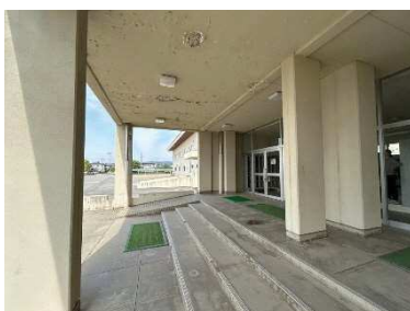
庇・屋根の劣化による雨漏り
