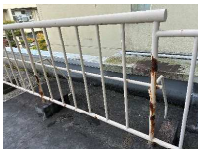
手すり等の腐食
