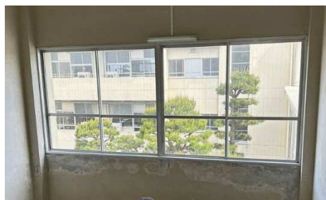
階段窓部の結露による壁面の劣化
