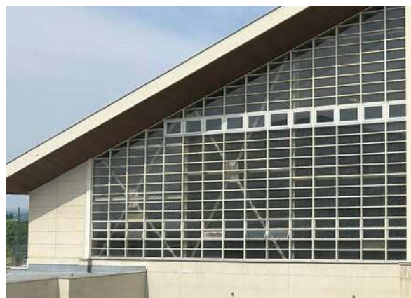
特殊な窓形状により修理できず、空いたままの体育館窓
