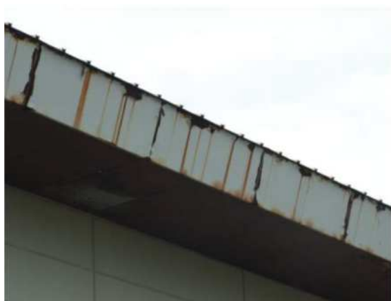
金属屋根の劣化状況
