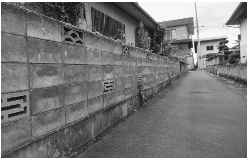
まだ多く見られるブロック塀
