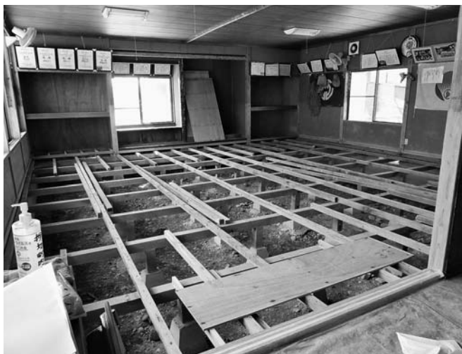
床上1mまで浸水した押切の自治公民館
