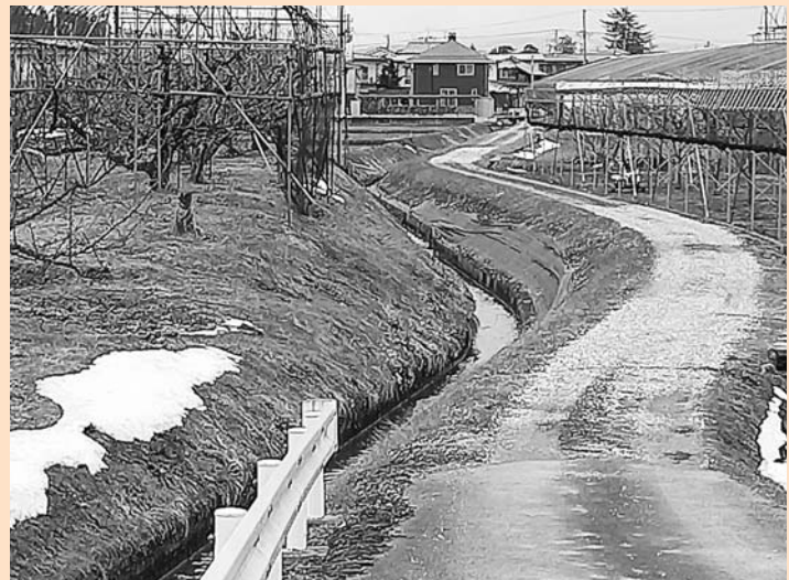
内水氾濫した柏川(溝延)
