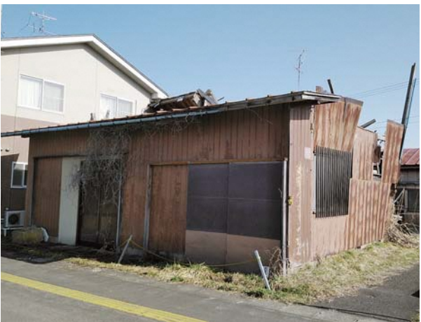
危険な空き家
