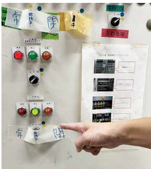
水風呂用水温冷却装置のチラー装置制御盤
