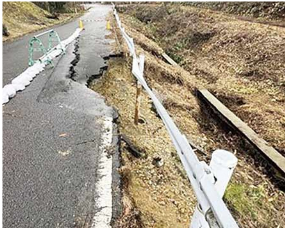
路肩崩れで危険な状態の町道両所山口線
