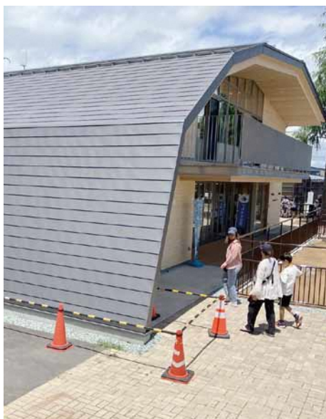
南側の側面鋼板の安全対策を
