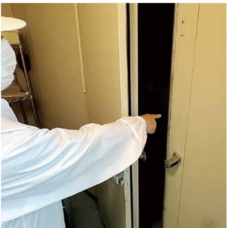
パッキンの劣化が原因で冷気が漏れている給食センター冷凍庫の扉
