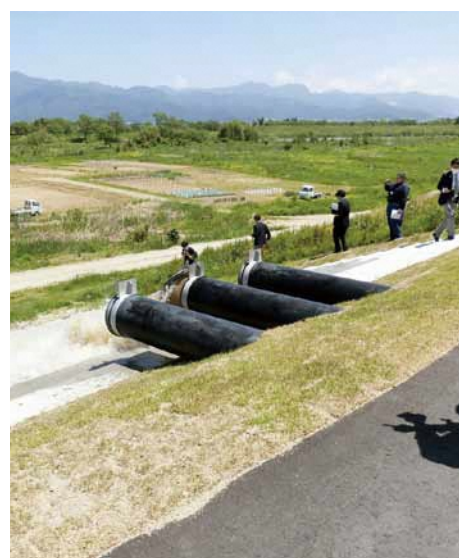
押切地区に完成した 毎分最大45トンの排水ポンプ
