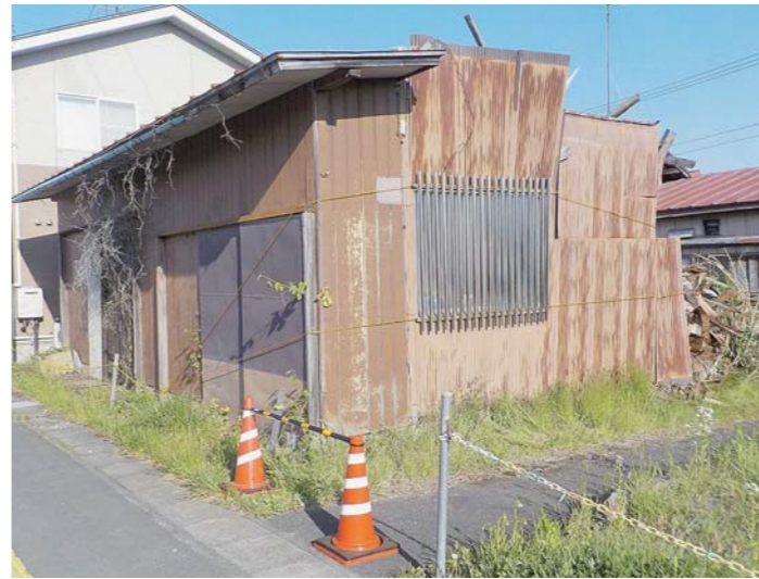
ボロボロの空き家
