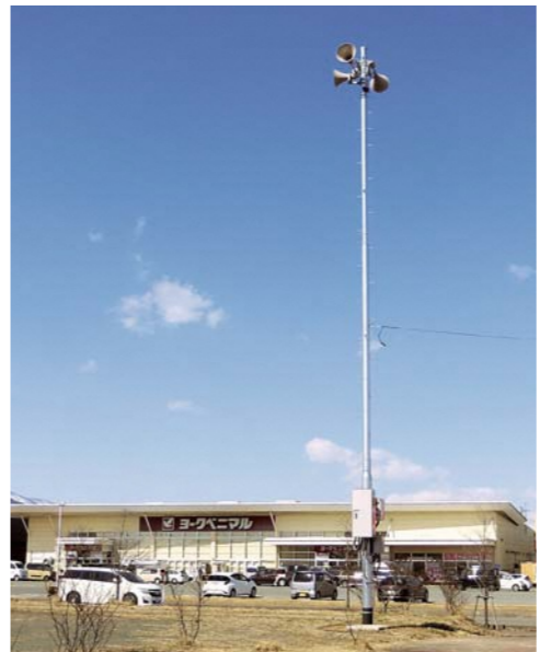
新設されたひな市の防災スピーカー
